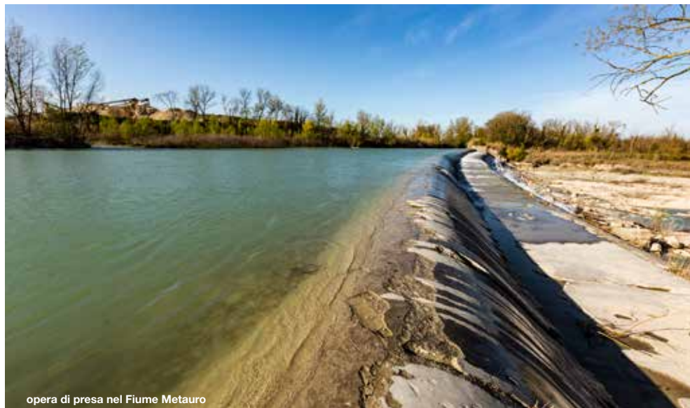
opera di presa nel Fiume Metauro
